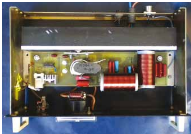
Slika 1. Pogled u unutrašnjost predajnika
